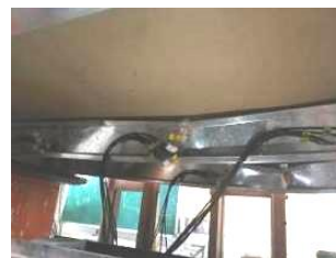
(d) – Tendency of lateral torsion buckling of steel beam-B
